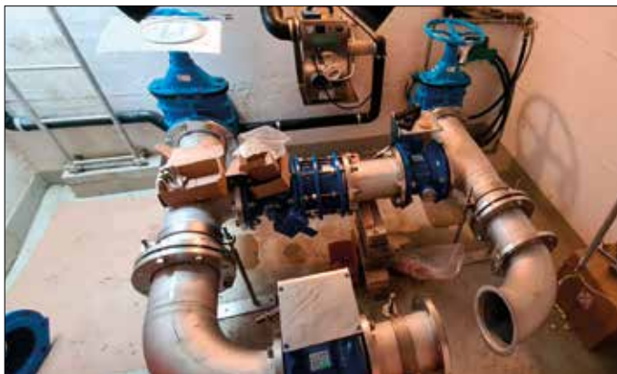
Der Klappenschacht Oedenhof während den Umbauarbeiten. Er ist nebst dem Reservoir Rötלבoden das Herz des Wassermanagements in der Druckzone Neftenbach.
